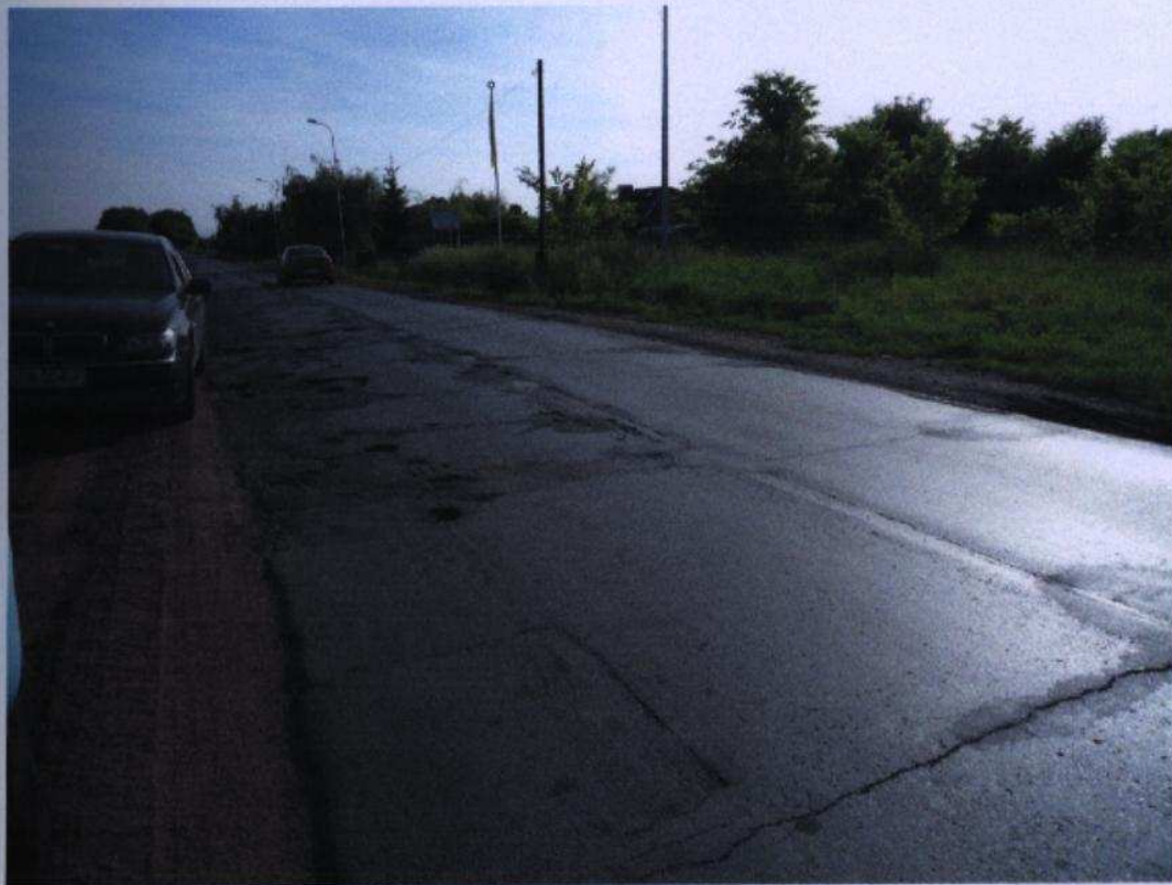
Fot. Z4. Widok zniszczeń nawierzchni
