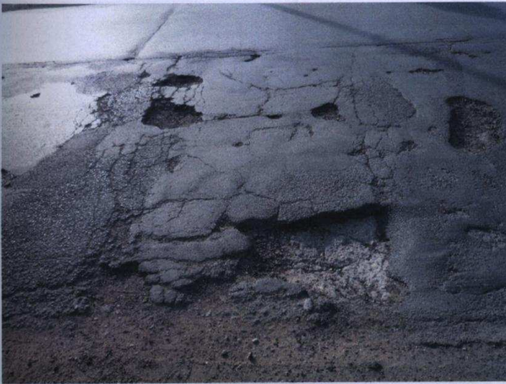
Fot Z2. Widok zniszczeń nawierzchni
