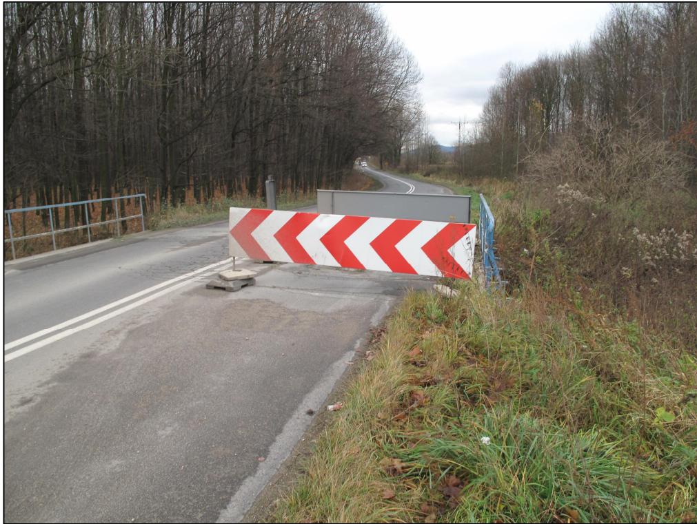
Rys. 4.1. Zabezpieczenie uszkodzonej nawierzchni obiektu, tymczasowa organizacją ruchu
