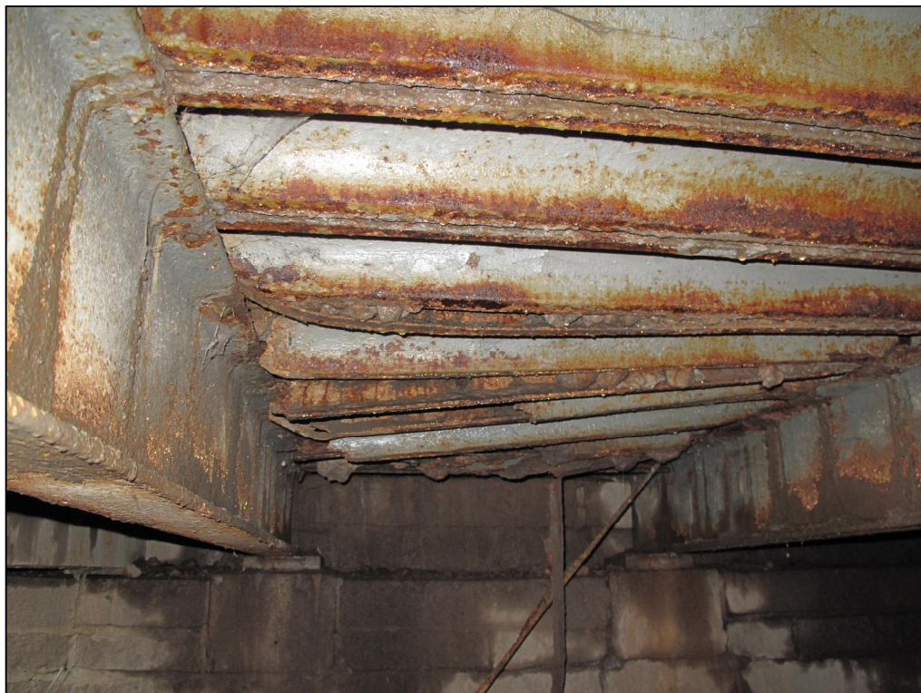
Rys. 4.8. Zaawansowana korozja blach pomostu oraz korozja powierzchniowa dźwigarów głównych, spowodowana brakiem izolacji - pomost stanowią blachy stalowe typu ZORES, ułożone bezpośrednio na dźwigarach głównych
