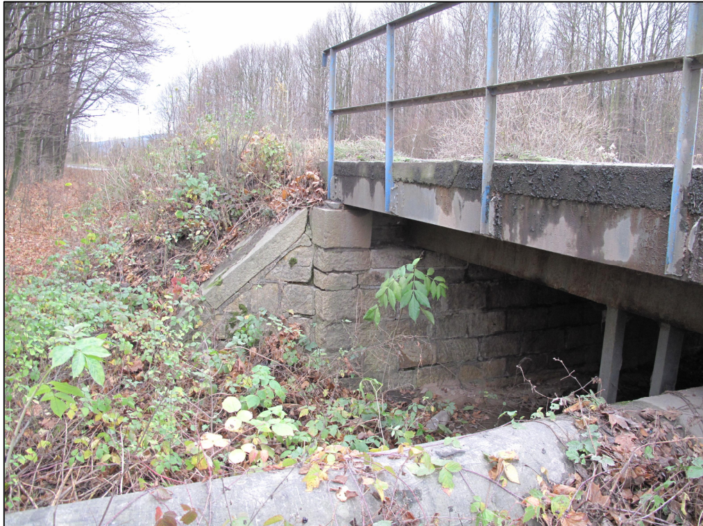
Rys. 4.7. Masywne kamienne przyczółki obiektu, których stan techniczny jest dostateczny, występują liczne uszkodzenia, ubytki materiału i spoinowania, widoczne zawilgocenia
