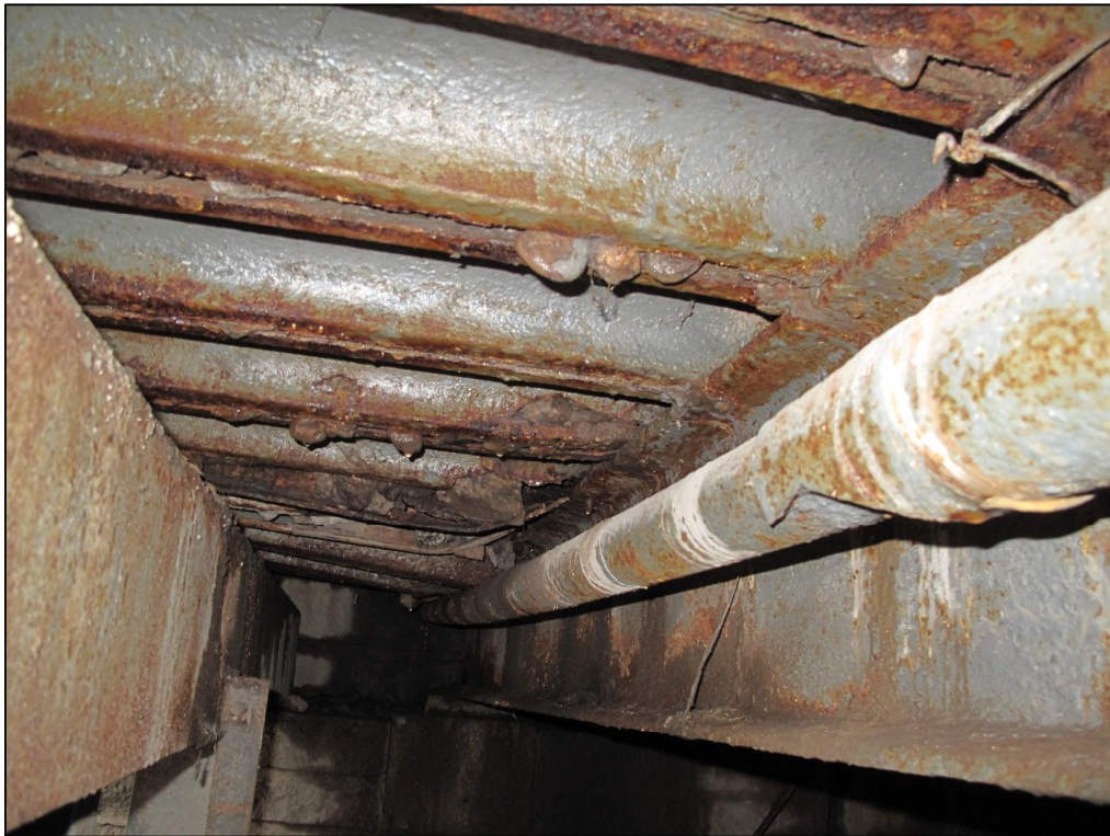
Rys. 4.11. Uszkodzona ostona urządzenia obcego, biegnącego wzdłuż jednego z pięciu dźwigarów głównych ustroju niosącego
