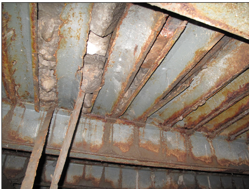
Rys. 4.9. Uszkodzenia pomostu spowodowane przeciekami wody z nawierzchni jezdni, stara konstrukcja nawierzchni wykonana z kostki betonowej na podsypce piaskowej wypada poprzez uszkodzony pomost – awaria
