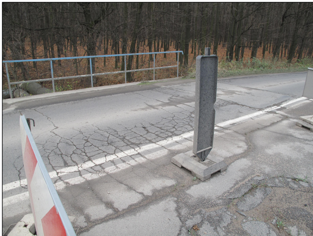
Rys. 4.4. Uszkodzenia nawierzchni jezdni bezpośrednio związane z uszkodzeniem płyty pomostowej obiektu
