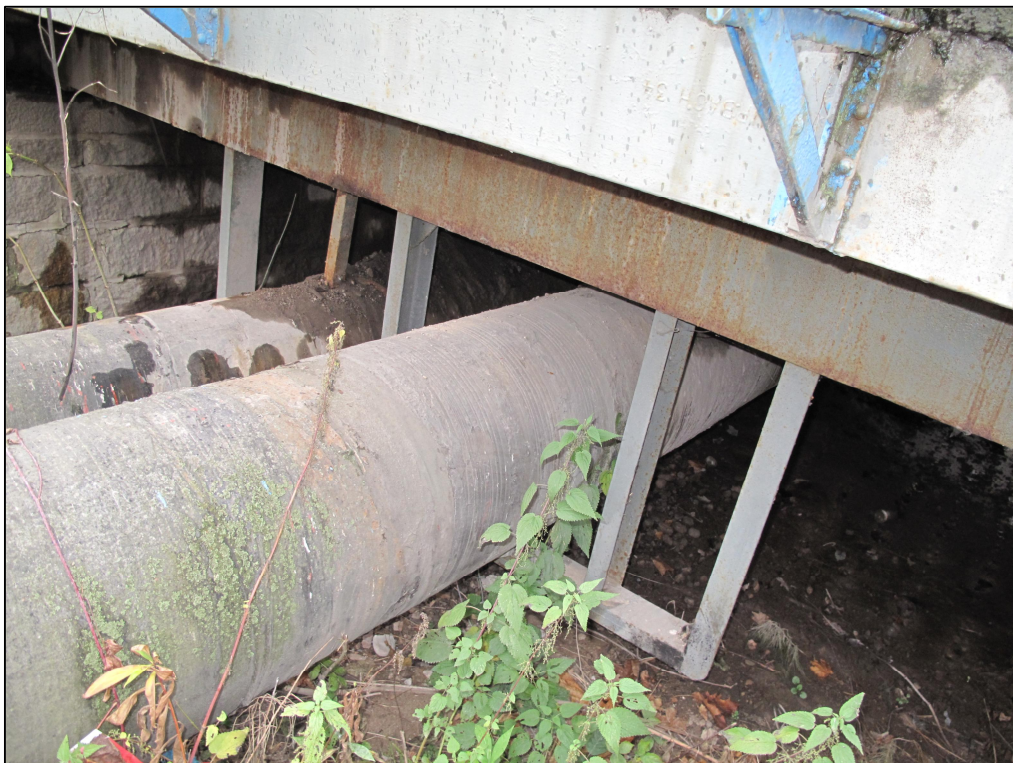
Rys. 4.12. Dwie rury stalowe ciepłownicze śr. 800 mm, ułożone na stalowej konstrukcji wsporczej, podwieszanej do niezależnej belki stalowej opartej na ławach podłożyskowych
