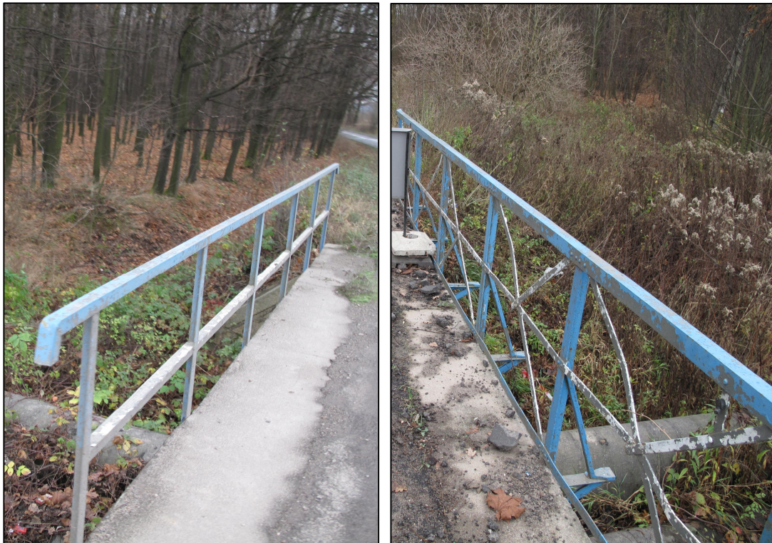
Rys. 4.5. Stalowe barierki na moście i skrzydłach o nie normatywnej wysokości ze śladami uszkodzeń mechanicznych i korozji - stan techniczny wskazuje na ich całkowitą wymianę
