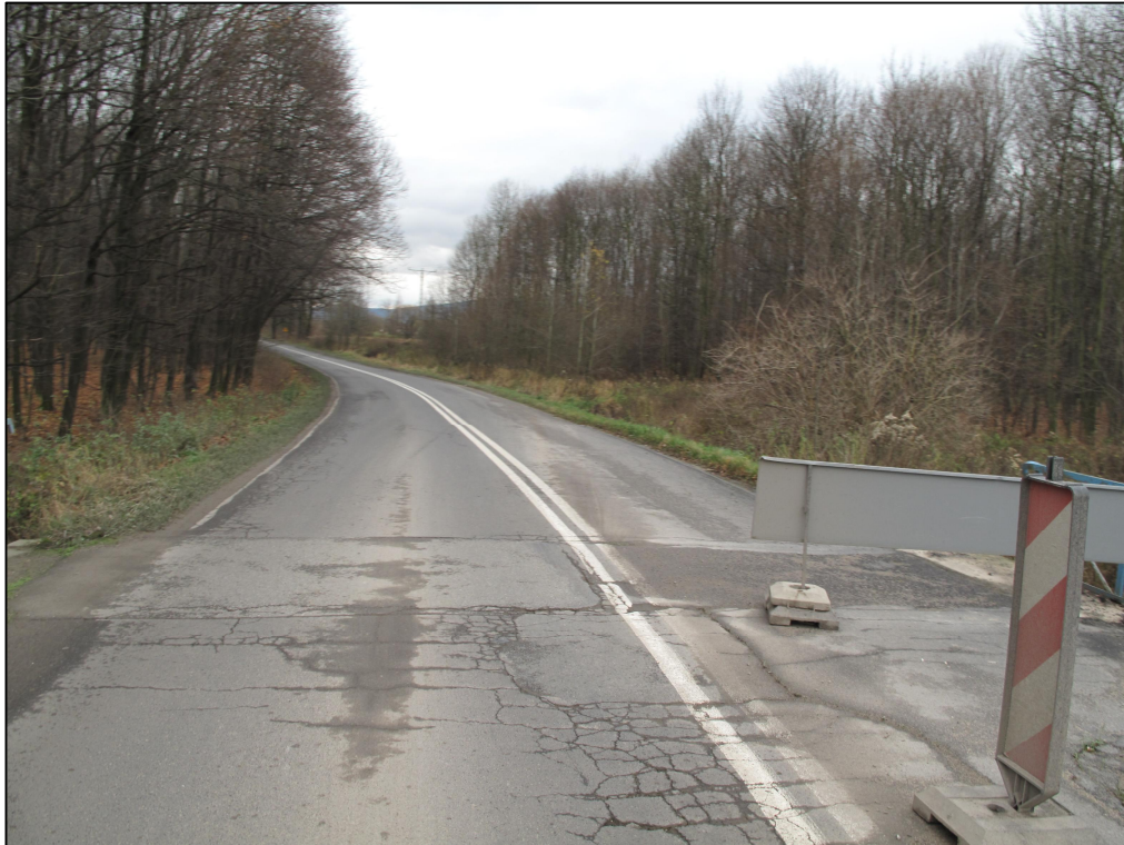
Rys. 4.2. Uszkodzona nawierzchni obiektu, po której odbywa się ruch kołowy
